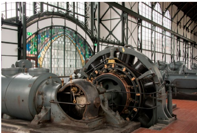
Die Maschinenhalle Zollerns mit Jugendstil-Portal und einem elektrisch betriebenen Kompressor von 1902.
